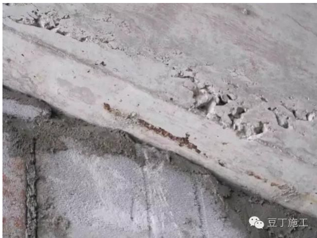
楼板板底露筋
