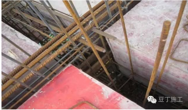
2) 框架梁柱节点核心部位柱箍筋数量不足
